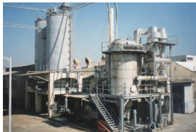
1990 형식 연산 3만 3,000톤 건조 공장
