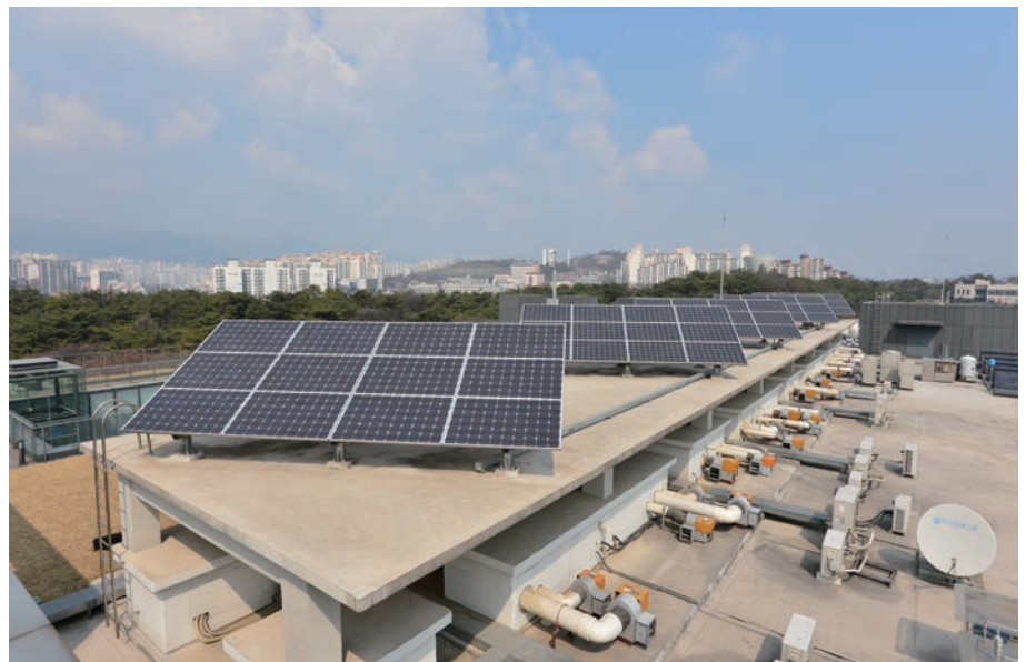
L4 연구동 옥상에 설치된 태양열 전지판
